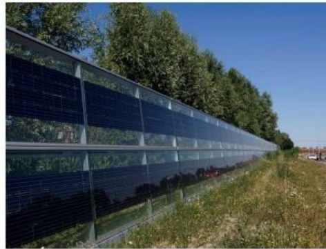
Pijnacker: zonnepanelen in de geluidswering
